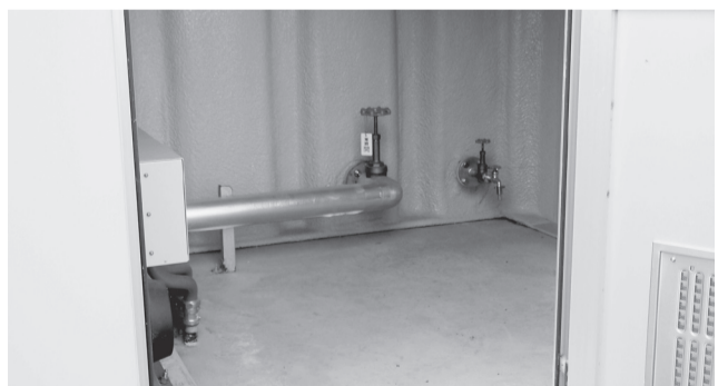
永山小学校受水槽(右の蛇口から取水可能)
