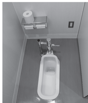
フラッシュバルブ式トイレ
