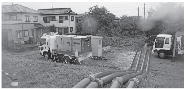
利根川増水時に内水を排水する様子(長町樋管付近)
