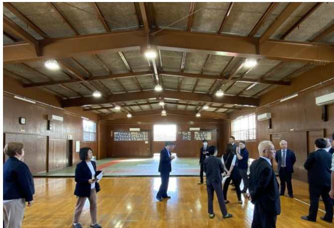
空調設備が設置された永山中学校の武道場
