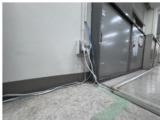
コンセント不足状況
