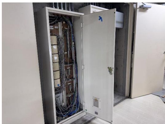
EPS（エレクトリック・パイプ・スペース）
