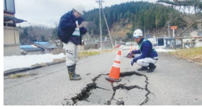
至る所に確認された道路の陥没
